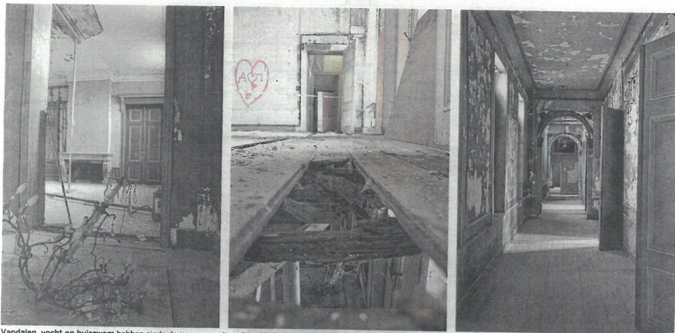
Vandalen, vocht en huiszwam hebben sinds de jaren negentig vrij spel in het ooit statige stadspaleis. Binnenkort wordt het gebouw gerestaureerd. © ktb
